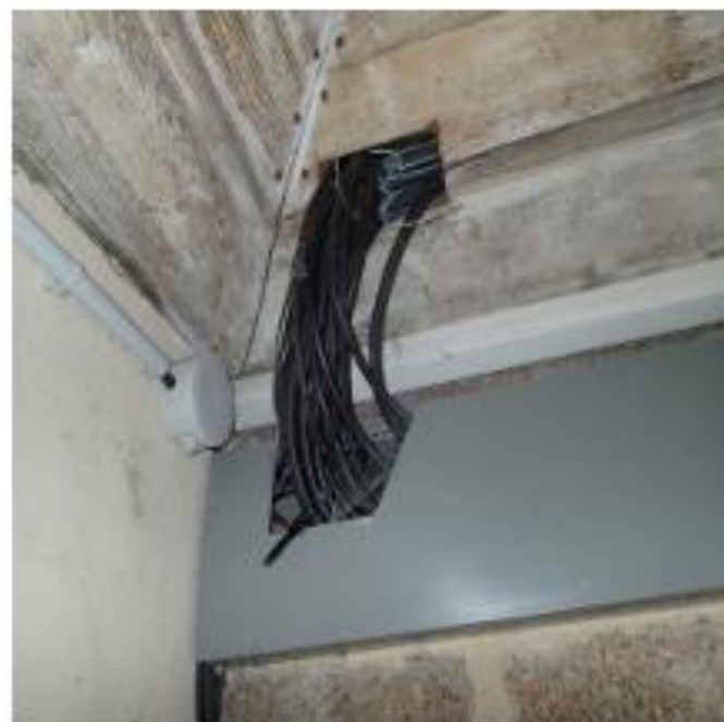
Départ de câble depuis le TGBT dans la sacristie.
