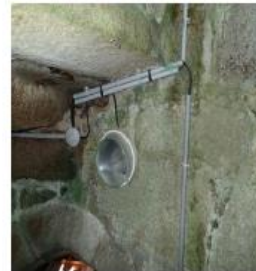
Éclairage escalier accès salle PIE X et combles
