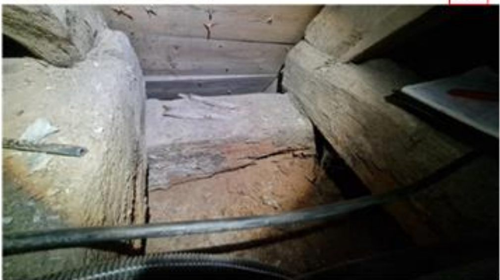
Photo 15 Etat sablière gouttereau. En général de cœur du bois reste résistant
