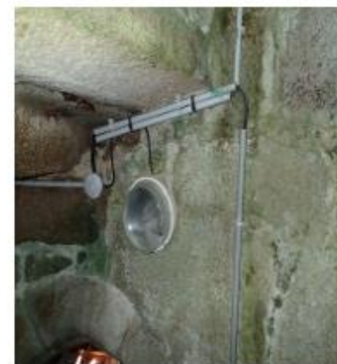
câbles dans l'escalier accès à la salle PIE X
