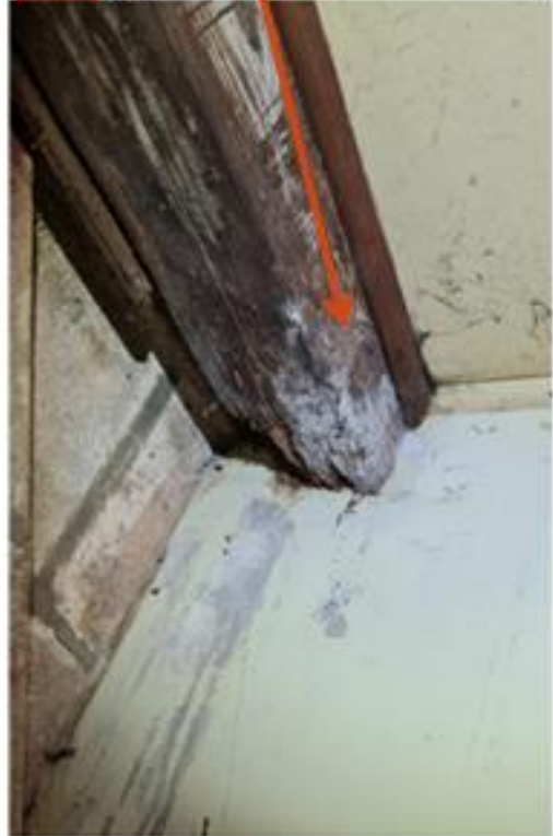
61 Photo 61 Etat de solive de rive à contrôler (HS)
