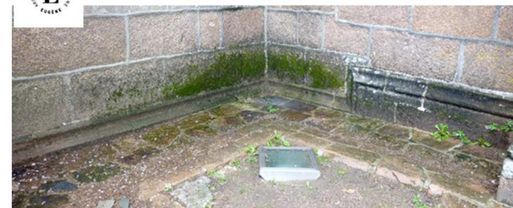
Ci-dessus en haut et en bas : Vues des traitements en pied de façades favorisant les remontées capillaires et les rejaillissements en bas de mur. Au centre : Vues de remontées de sels à l'angle Sud-Est intérieur de la chapelle et de coulées de calcification sur la face Ouest du clocher.
