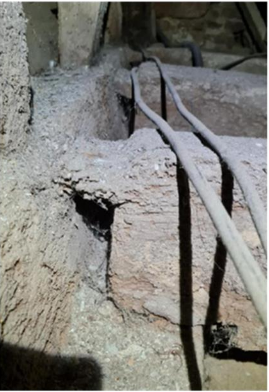
Photo 12 Déboitement d'une série de blochet Au niveau d'assemblage tenon/mortaise Jonction queue d'aronde blochet/sablière libres de mouvement suite au dégradation de sablière
